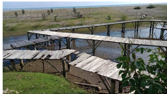
Gambar 1. 1 Tracking Mangrove yang rusak
